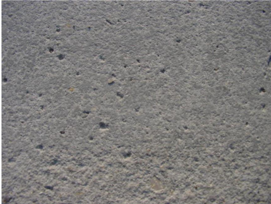
Löcher und Lunker in vorbereiteter Betonoberfläche
